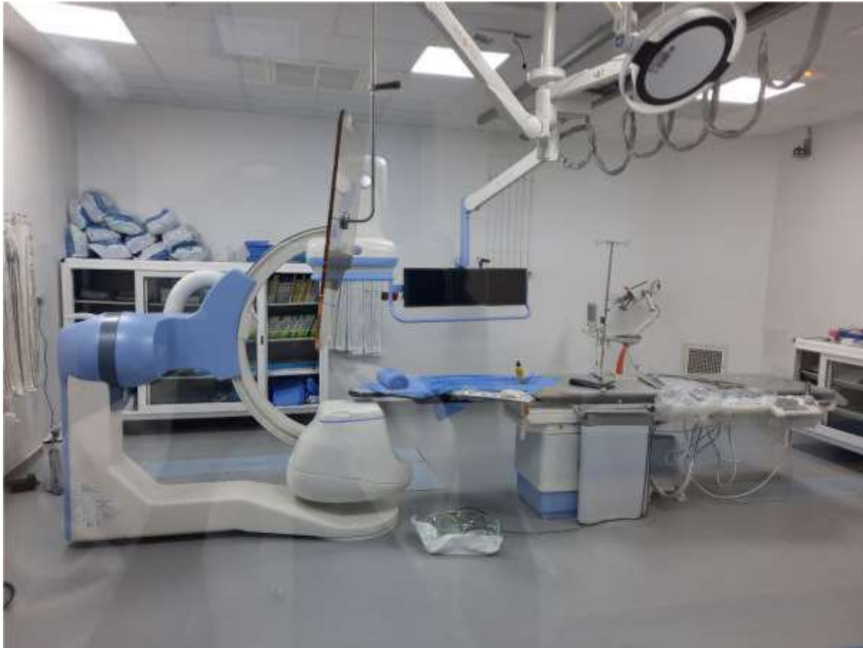
Figure 4 : Salle d'angiographie de l'unité de cardiologie interventionnelle au service de cardiologie au CHU Mère-Enfant Le « Luxembourg » de Bamako
